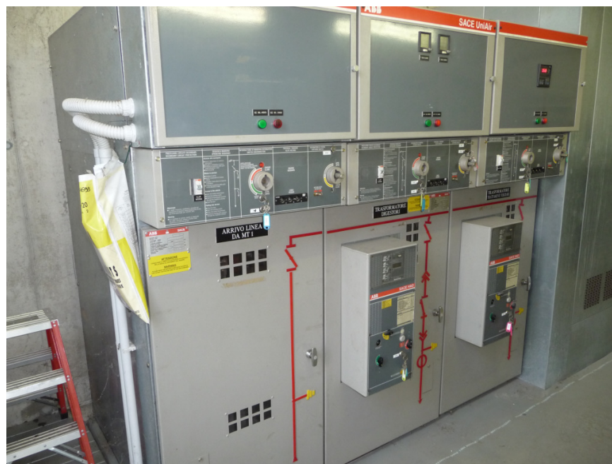
Fotografia 3 - Quadro MT da modificare
