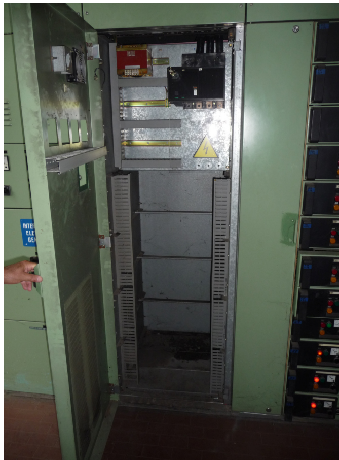
Fotografia 2 - Carpenteria dove verrà inserito il nuovo interruttore
